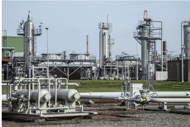
De installaties voor de ondergrondse gasopslag in Loenhout
